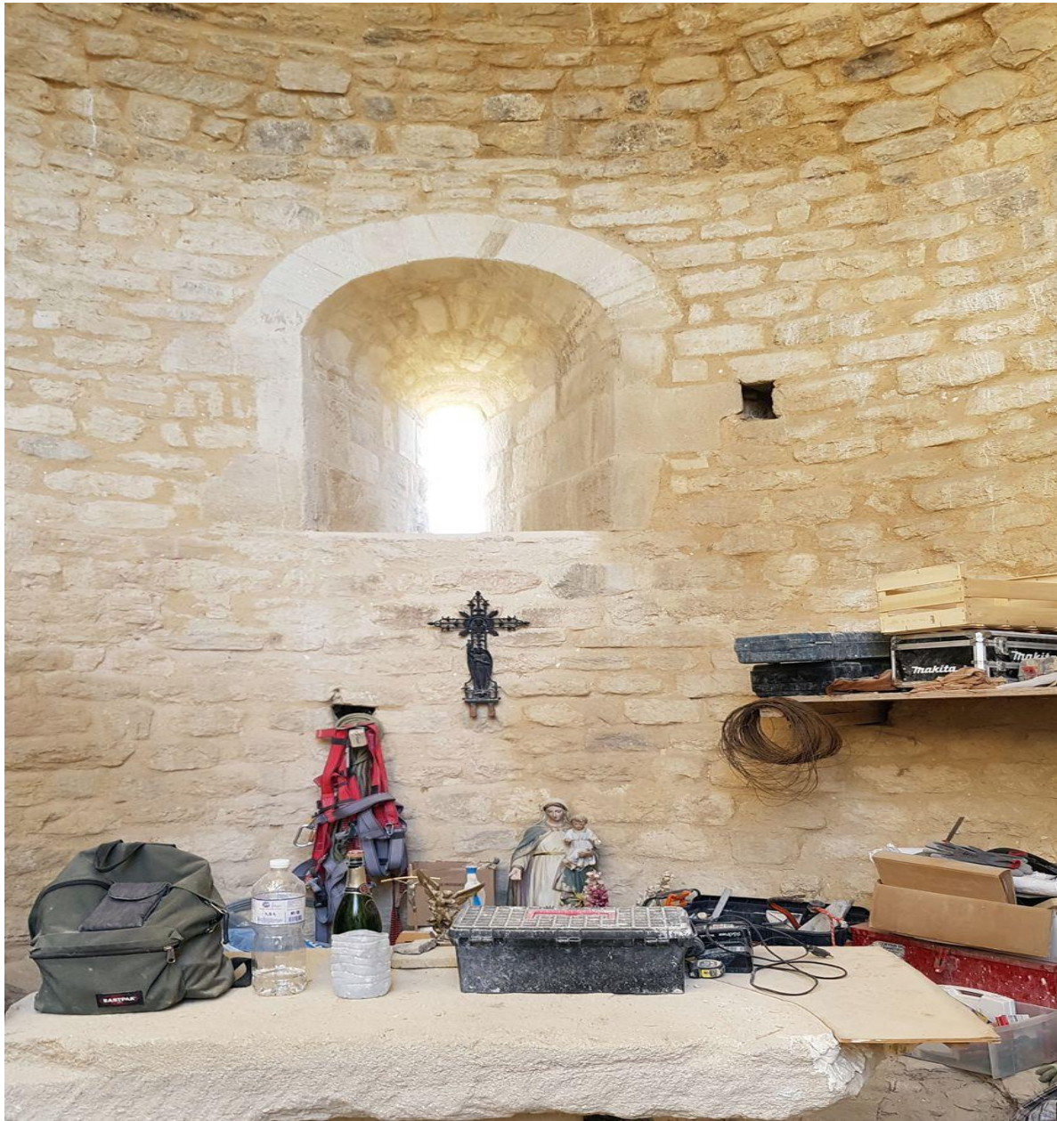
L'Autel de la chapelle, au temps des travaux. © Radio France - Philippe GARCIA
