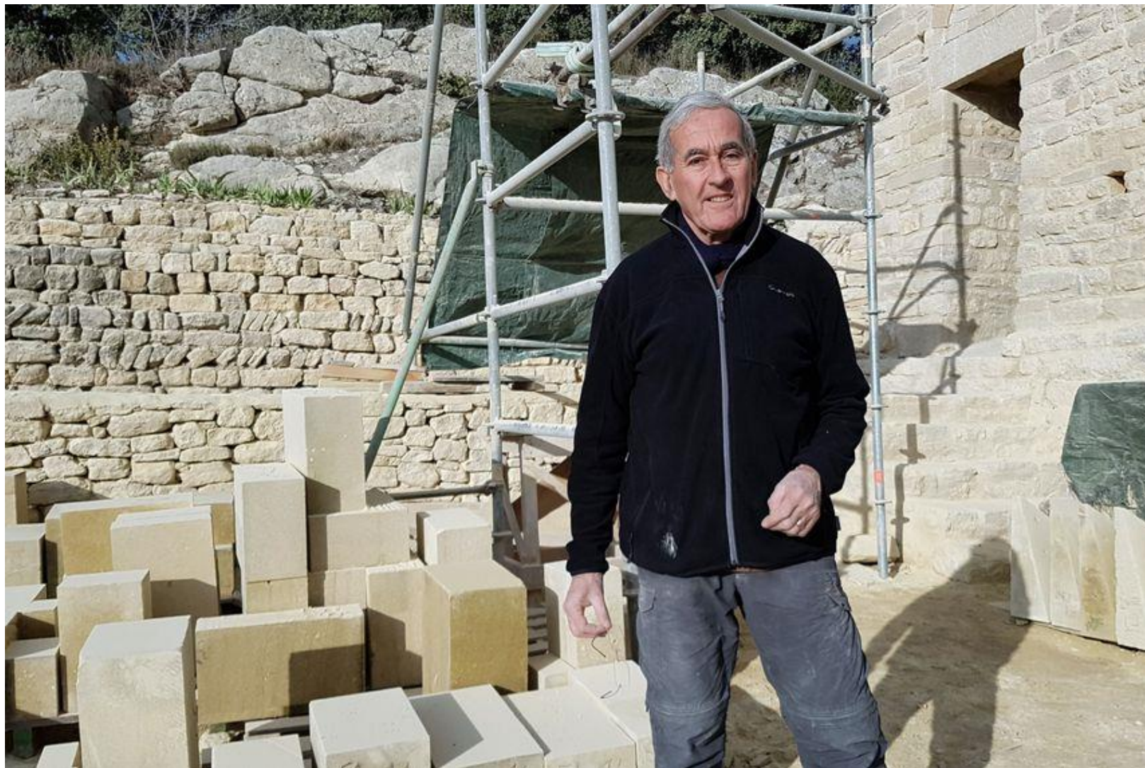
Yves de Kermabon sur le chantier de la chapelle © Radio France - Philippe GARCIA
